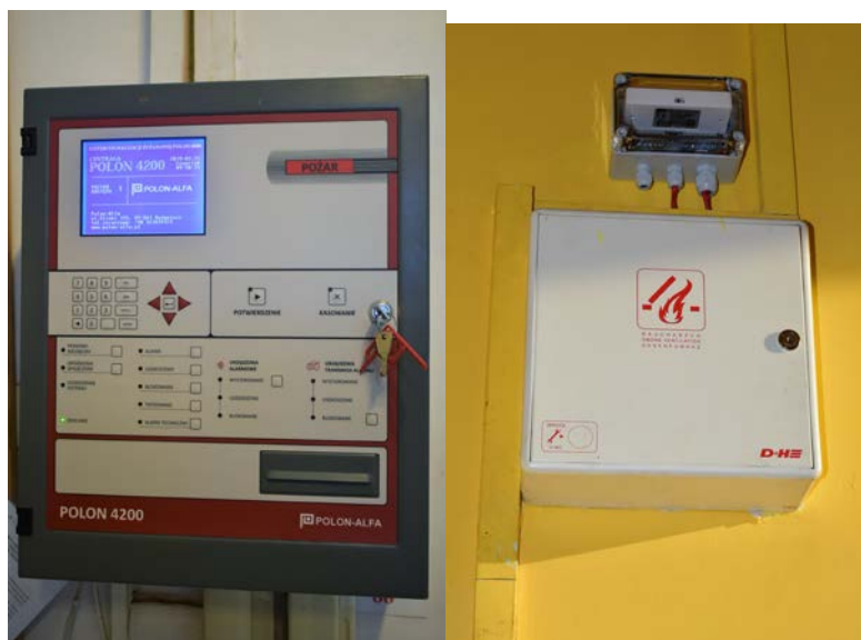
Nowa instalacja p-poż. w DPS Prudnik (2018)
